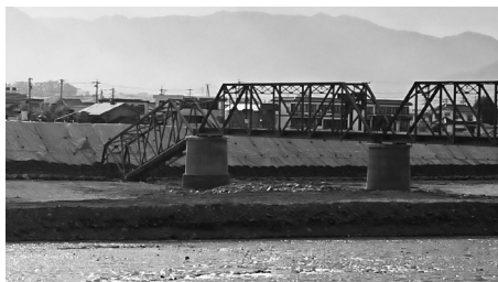
千曲川の堤防が削られて一部が川に落ちた上田電鉄の鉄橋（長野県上田市）
