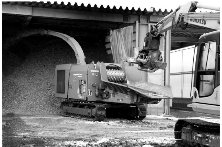
木質バイオマス原料製造施設
