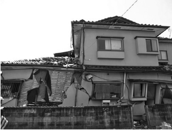
写真3 1階が傾いた新耐震基準以降の木造住宅
