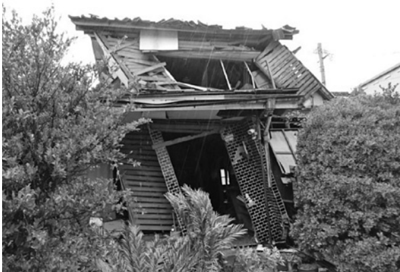
写真2 1、2階共に大きな残留変形があり倒壊寸前の古い木造住宅
